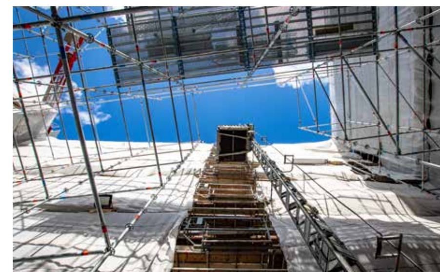
Voor de bouw van met name het atrium is een enorm steigerwerk nodig.
